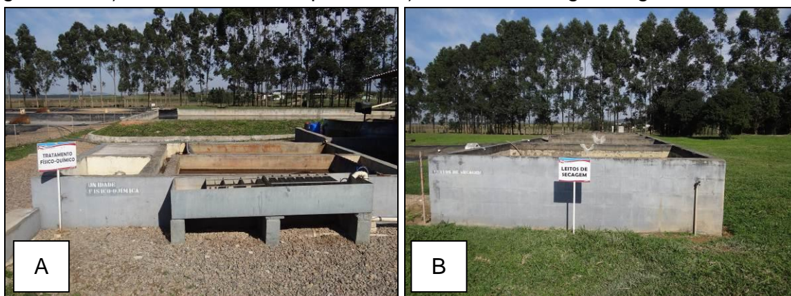
Figura 27 - A) Tratamento físico-químico; B) Leitões de Secagem. Agosto de 2013.
