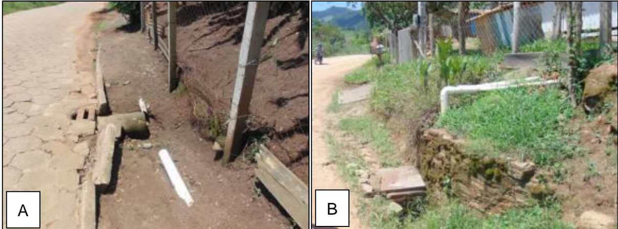
Figura 62 – A) e B) Redes de esgoto ligadas à rede pluvial.
