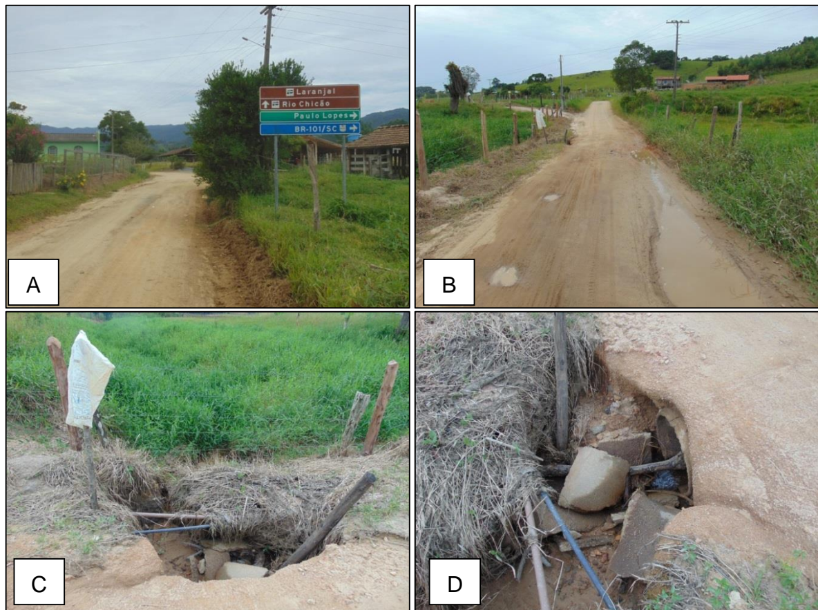
Figura 32 – A) Rodovia Municipal IMA-310. B) Ponto de inundação. C-D) Tubulação de travessia de via.
