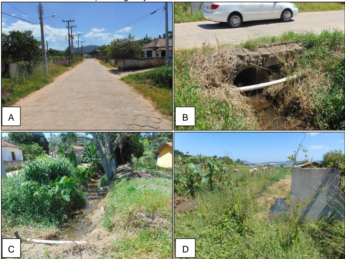
Figura 9 – A) Ponto da inundação. B) Tubulação travessia de via. C) Córrego a montante assoreado. D) Córrego a jusante.
