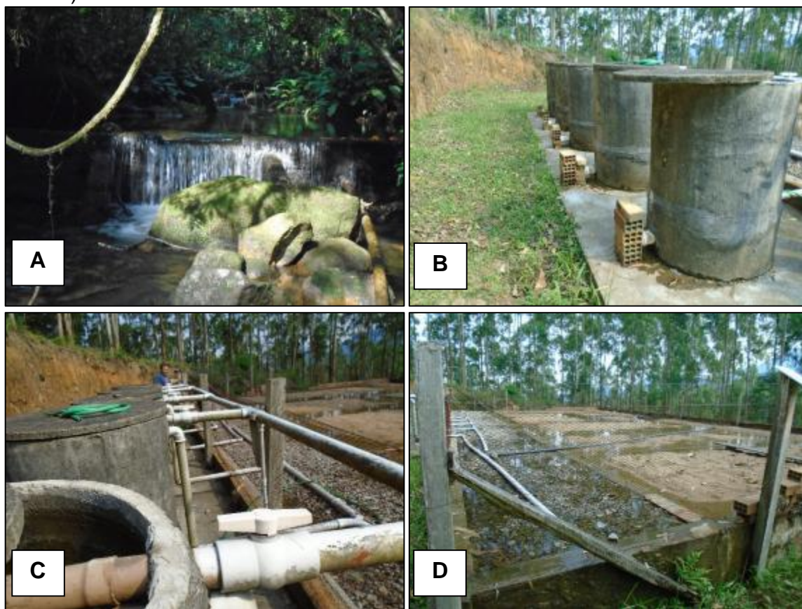
Figura 8 - A) Sistema de captação da comunidade de Aratingaúba, B e C) Filtros de Brita e D) Filtro modelo Junco.
