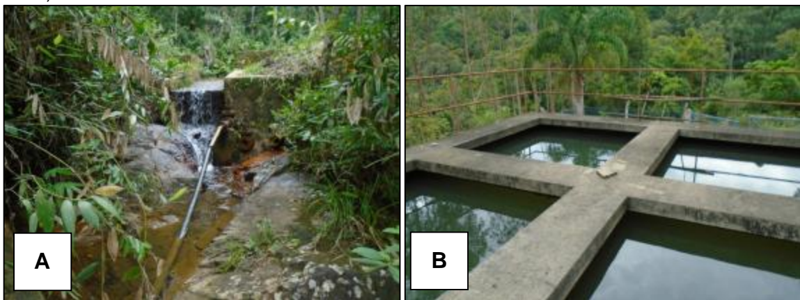
Figura 16 - A) Captação; B) Sistema de Filtros Descendentes; C e D) Casa de Química; E) Tubulação de entrada da água onde ficam as pastilhas de cloro no reservatório da comunidade indígena; F) Macromedidor instalado nos sistemas, porém, não funcionando.
