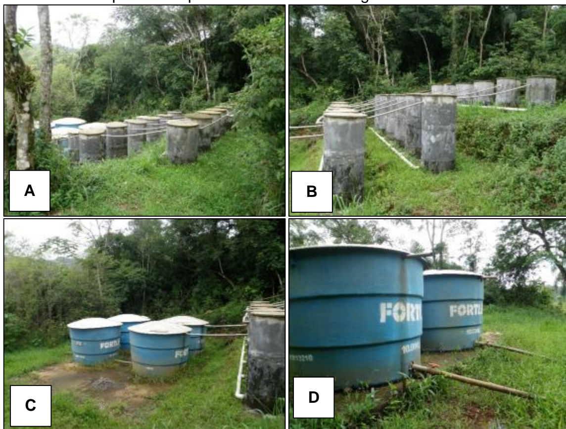
Figura 13 - A e B) Sistema de Filtros na comunidade de Cangueri de Fora; C e D) Reservatórios responsáveis pelo abastecimento de água.
