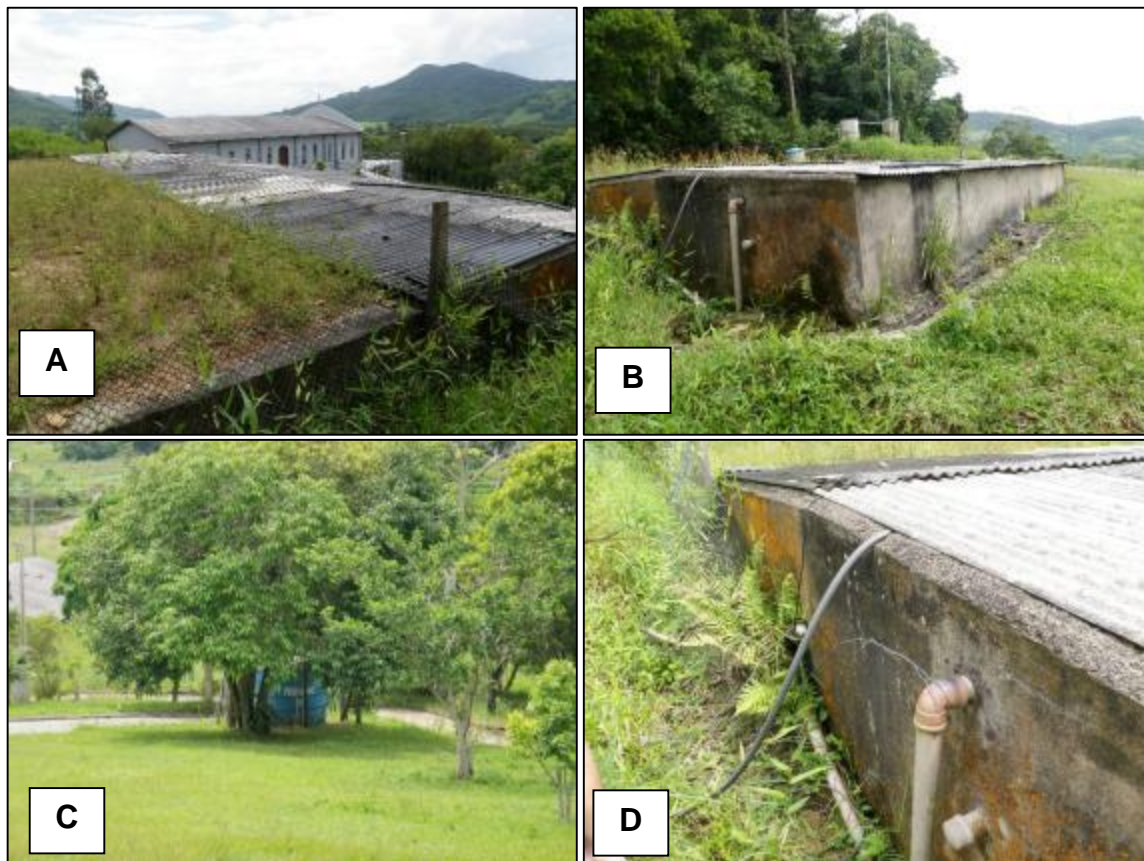
Figura 10 - A e B) Filtro modelo Junco da comunidade de Figueira Grande; C) Reservatório da comunidade de Figueira Grande; D) Tubulação clandestina liga ao sistema.
